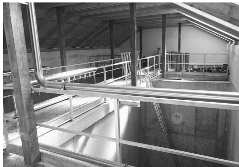
Pohled do nadzemní části a nádrží čistírny
